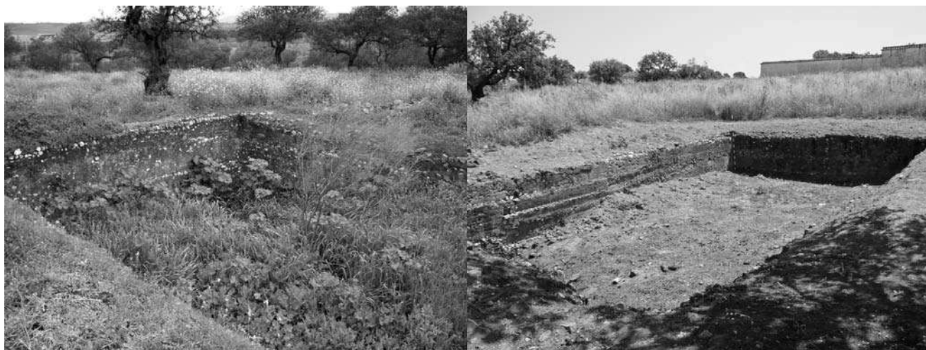
Figura 7: Antes y después en el proceso de limpieza de la cisterna superior. Foto: Esperanza Rosas
